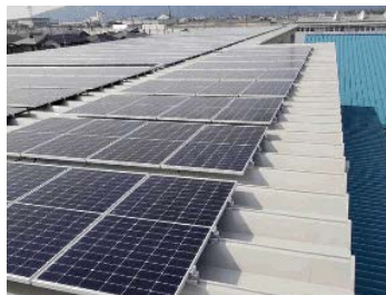
太陽光パネル
