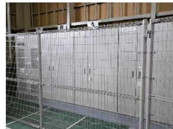
リチウムイオン蓄電池
